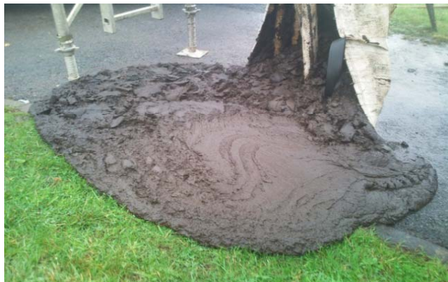
Non EK dewatering 8% ds
